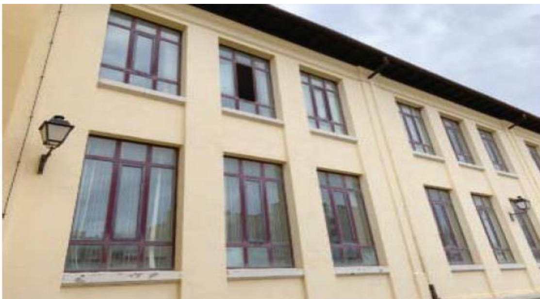
1/ - fasáda ve zhoršeném stavu
